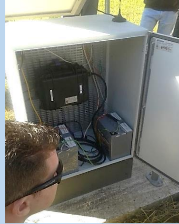
Corint Körfezi sismometresi için kayıt ekipmanı ve yedek elektrik kaynağı
