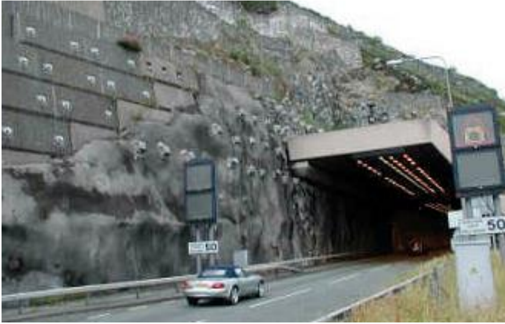
Şekil C 20. Kuzey Galler otoyolu, Pen-y-Clip tüneli girişinde, kaya düşmesine karşı alınan önlemlere ilişkin olarak beton istinat duvarı, gabyon duvar (her ikisi de fotoğrafın üst kesiminde), kontrol çiti, kaya bloğu ile iyileştirme ve destekleme (Fotoğraf: Dave Giles, Engineering Geology Consultancy Group, University of Portsmouth, United Kingdom).
