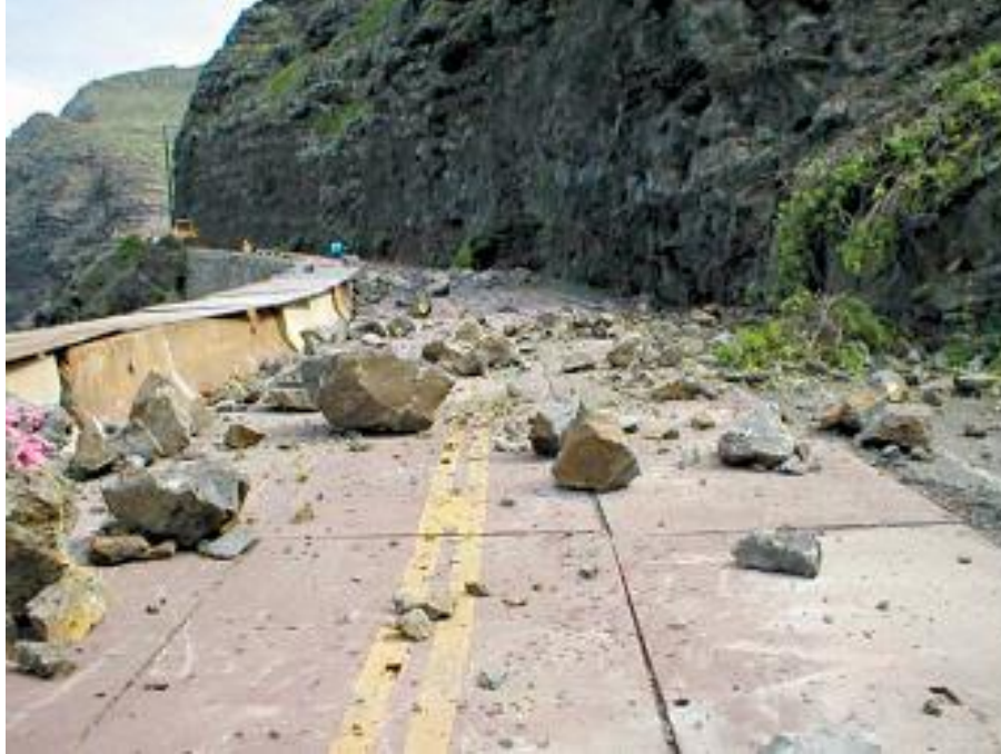
Şekil C 29. Şev düzenleme ve patlatma çalışmalarını sonucu düşürülen kayalar (Fotoğraf: Washington Department of Transportation, ABD).
