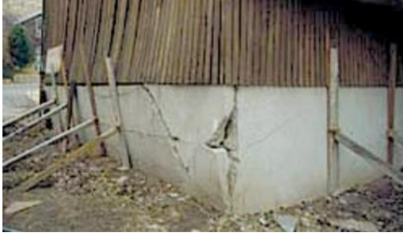
Şekil 38. Bir yapının temelindeki çatlamlar (Utah Jeoloji Araştırmaları biriminin izniyle).
