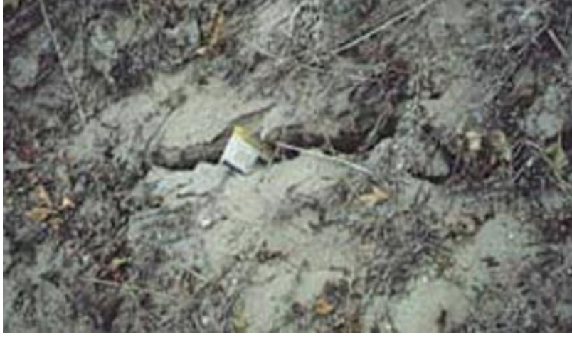
Şekil 36. Zeminde açılma çatlakları (Utah Jeoloji Araştırmaları biriminin izniyle).
