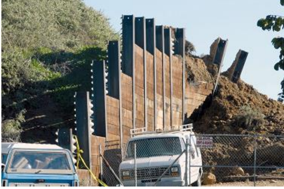
Şekil C 36. Moloz akmasına karşı yapılacak istinat duvarlarının yer seçimi ve yapımı için özel dikkat gereklidir. Fotoğrafta La Conchita (Kaliforniya)'da kereste ve çelik kırıli bir istinat duvarı görülmektedir. Yapı 1995 yılında oluşun heyelan sonrasında evleri koruma amacıyla yapılmış olmasına rağmen, 2005 yılında meydana gelen moloz akmaları sonucu zarar görmüştür. Duvar, bazı yapıları korumuş ancak ağır hasar görmüş, ayrıca duvar yapısının yönlendirmesi sonucunda başka bir ev hasar görmüştür (Fotoğraf: Randall Jibson, USGS).
