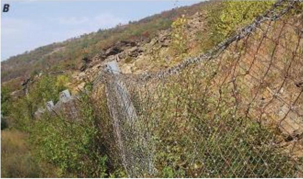
Şekil C 22. Yol kenarlarında uygulanan koruyucu kaya bariyeri, Pensilvanya, ABD (A), Kaliforniya ABD (B). (Foto A: Lynn, Highland USGS, Foto B: Federal Karoyolu İdaresi, ABD).
