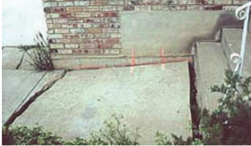
Şekil 37. Ev kenar kaldırımının yapıdan ayrılması (Utah Jeoloji Araştırmaları biriminin izniyle).
