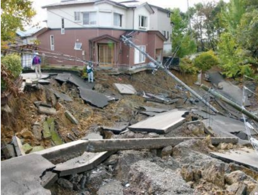
Şekil 27. Yapay dolgu zemin üzerine inşa edilen bir evde, 2004 tarihli Niigata Prefecture (Japonya) depremi tetikleme ile oluşan heyelanın yol açtığı hasarlar (Fotoğraf: Profesör Kamai, Kyoto Üniversitesi, Japonya).
